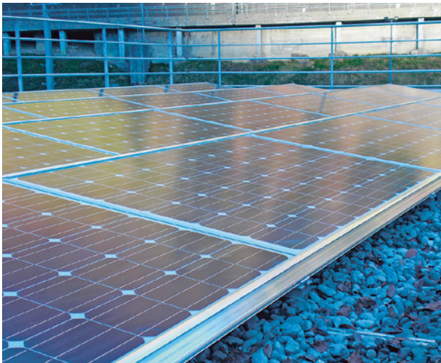
4 Solaranlage auf Flachdach mit umlaufendem, permanentem Geländer
