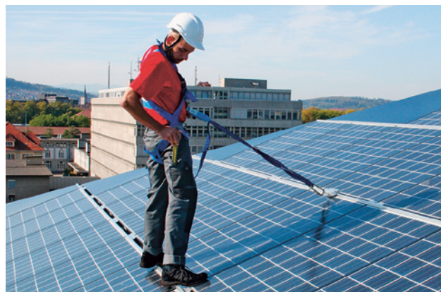
12 Anschlageinrichtung, in Solaranlage integriert
